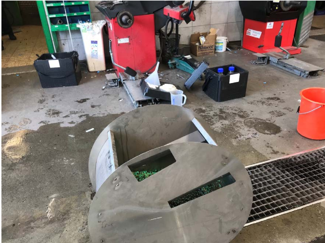
Behållare för uppsamling av plastgranulatet innan spillvatten tappas ur däcktäckmaskinen. (Örby Gummi)
