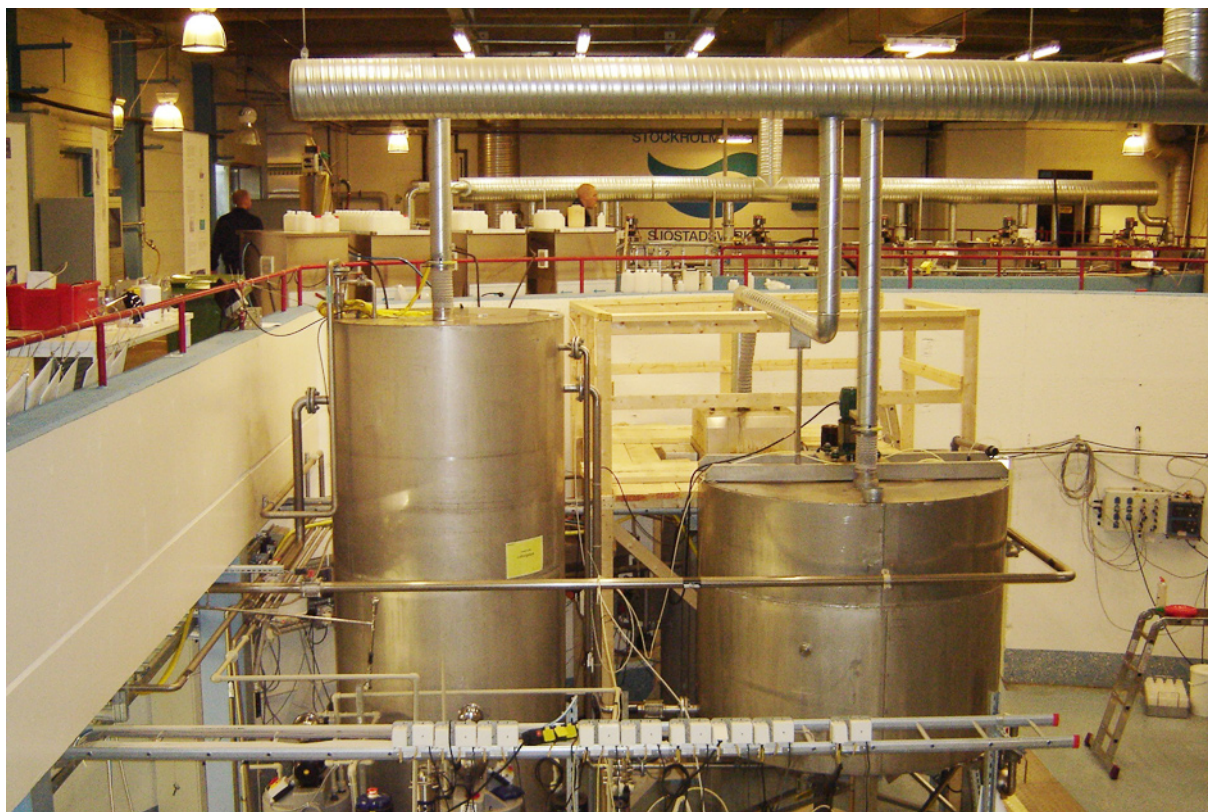
Figur 5-7 Nitrifikationstank och denitrifikationstank.
